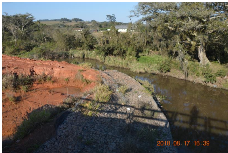
Figura 31 – Estrangulamento do leito do Arroio Passo fundo A montante da Ponte sobre a BR/116
