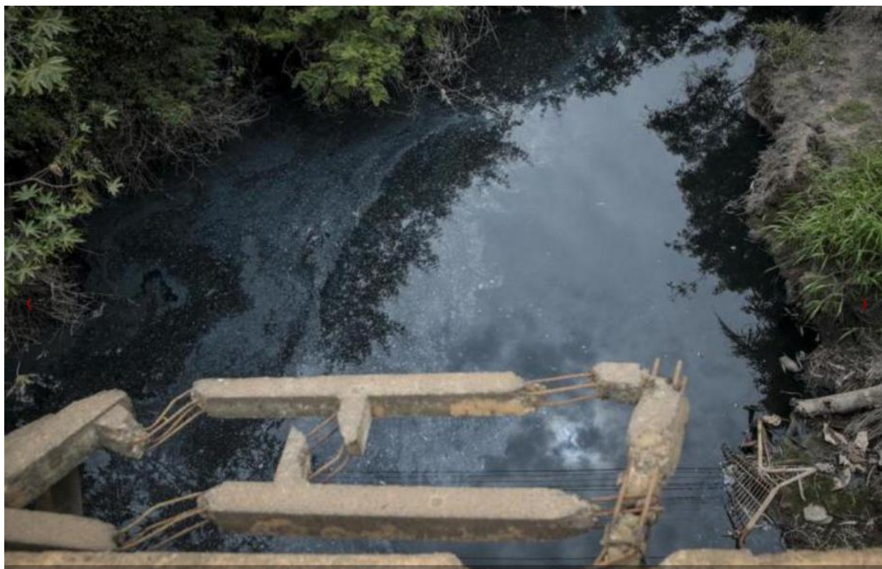
Figura 10 – Vista da poluição do Arroio Passo Fundo Sobre a ponte da Rua Adão Foques – Fonte: internet/RBS
