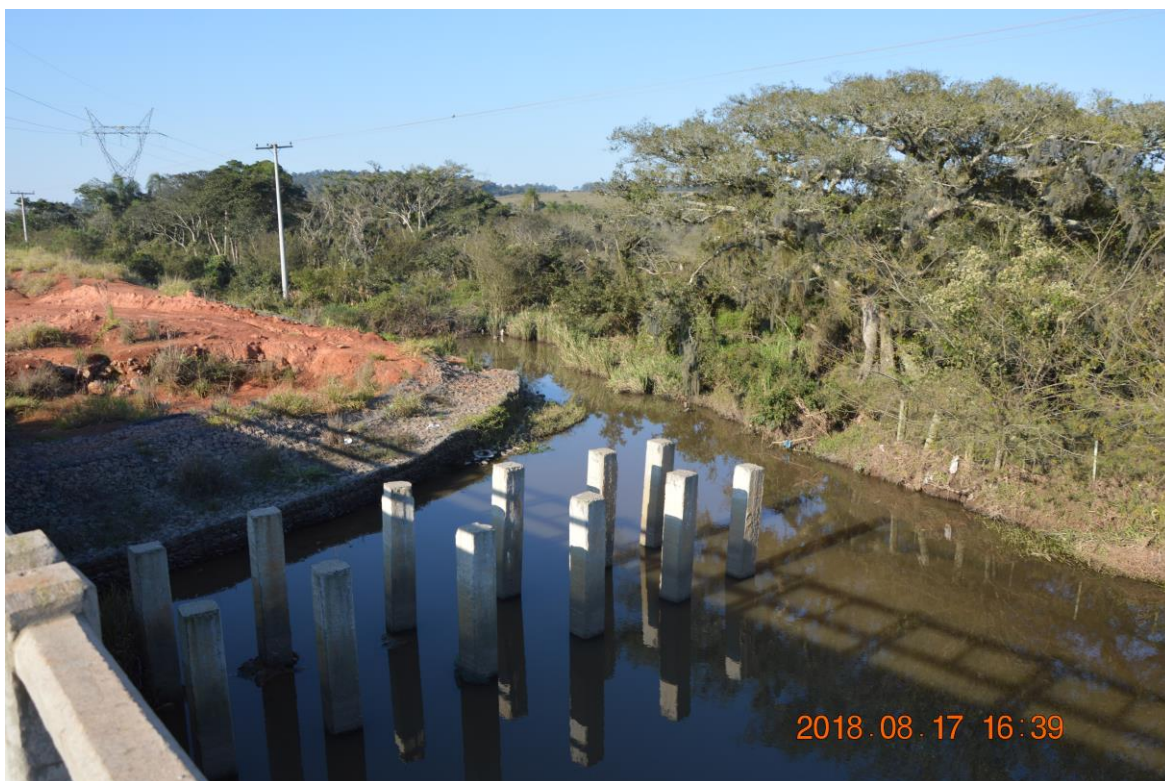
Figura 61 – Estrangulamento do Arroio devido a terraplenagem do alargamento da segunda pista. Prever o transplante da figueira de suas margens.
