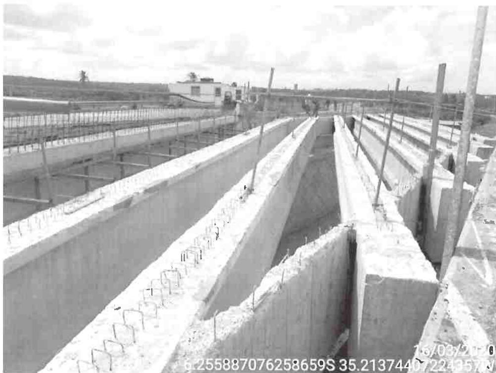
Foto 2 - Laje sentido João Pessoa/PB - Natal/RN.
