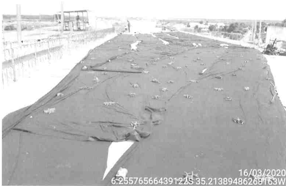
Foto 1 - Laje sentido Natal/RN - João Pessoa/PB.
