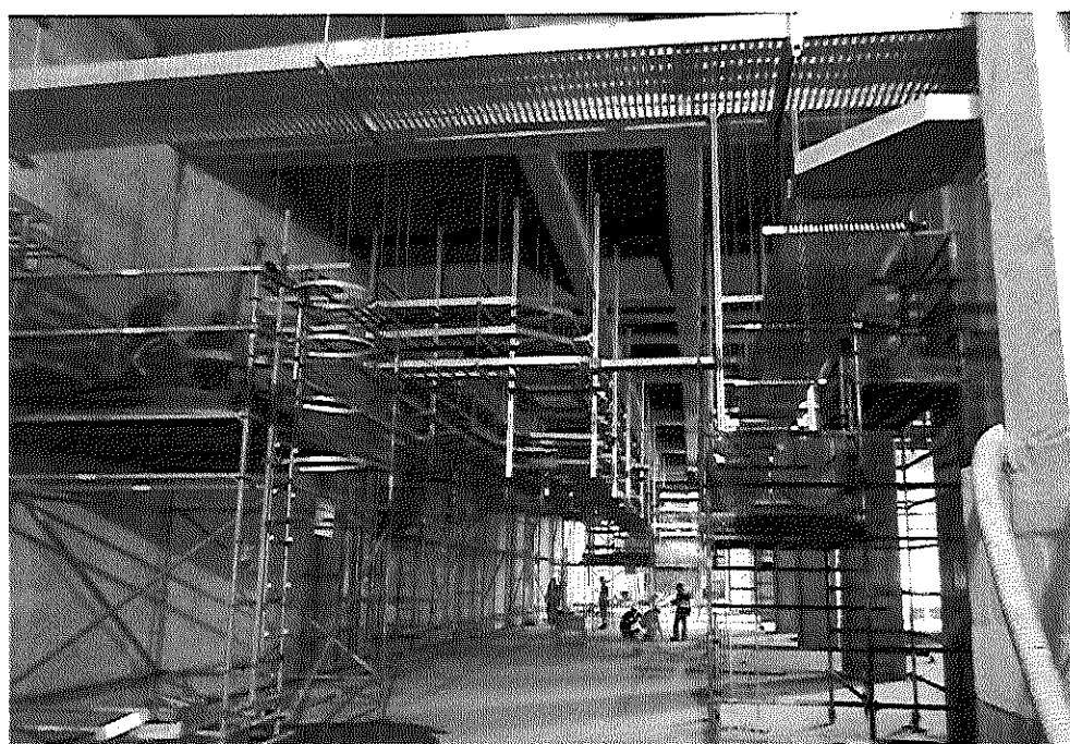
Sítio Pimental – AM – Central Elétrica - Bandeamento Elétrico
