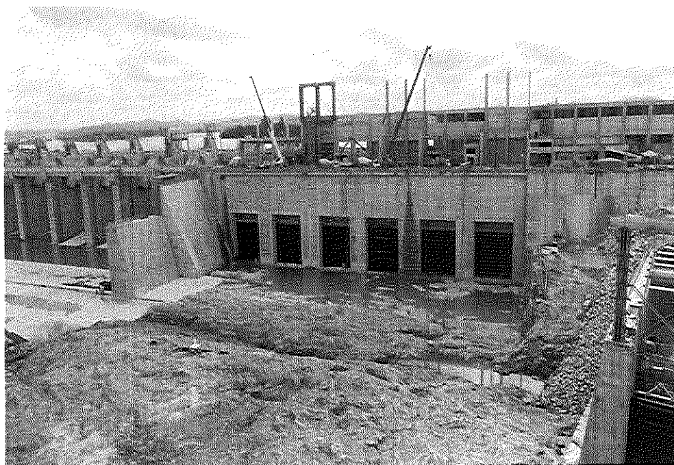
Sítio Pimental – Casa de Força
