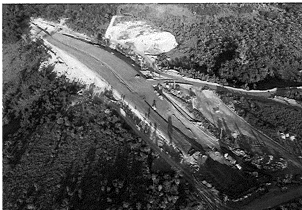
Reservatório Intermediário - Dique 29
