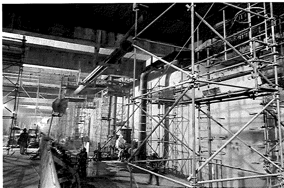
Sítio Belo Monte - UG01 – Galeria Mecânica Inferior
