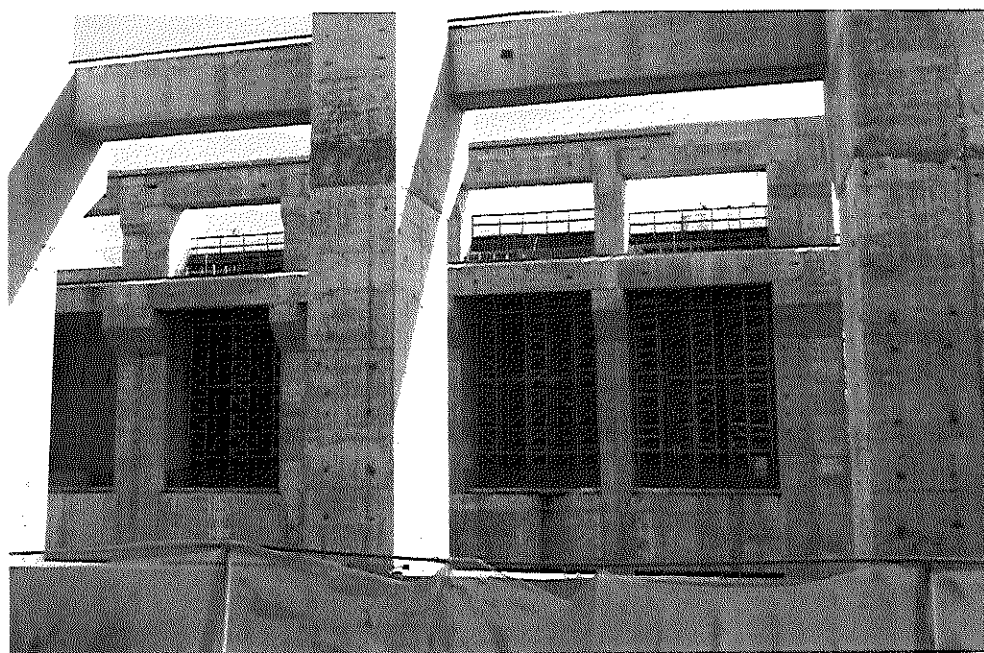
Sítio Belo Monte - UG04 – Subestação blindada (GIS)
