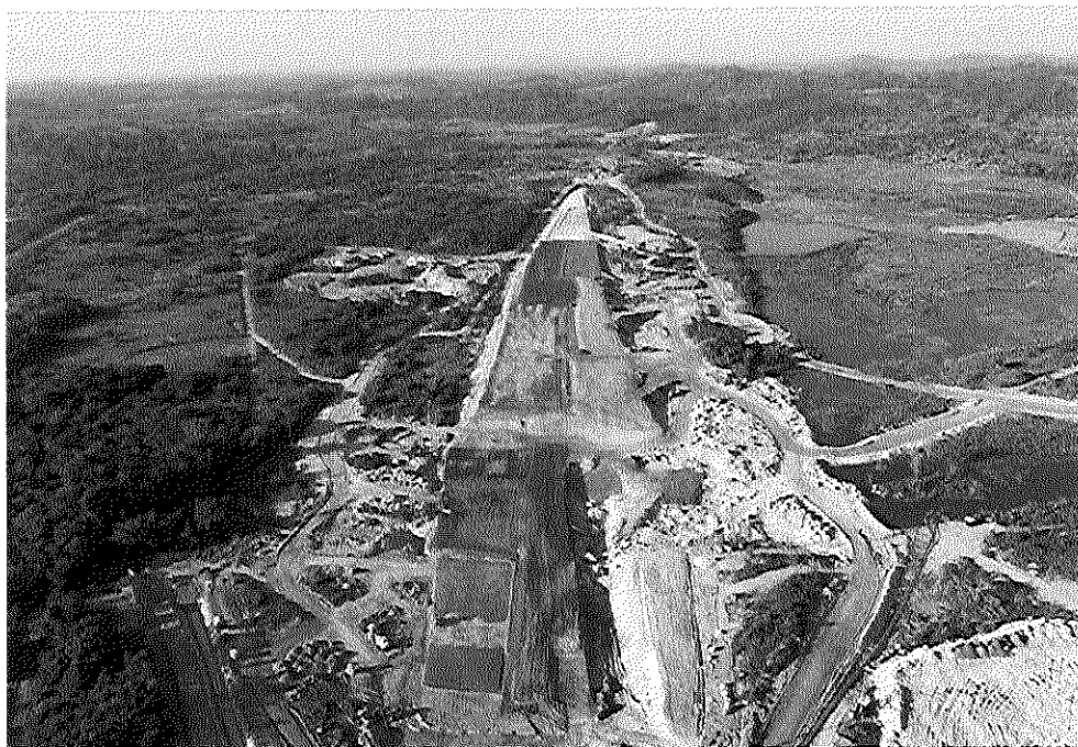
Reservatório Intermediário - Dique 28
