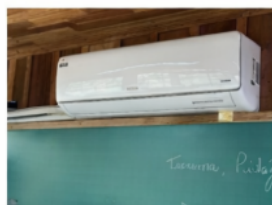
Ar-condicionado – Escola estadual Princesa Isabel (Mun. Cerro Azul/PR)
