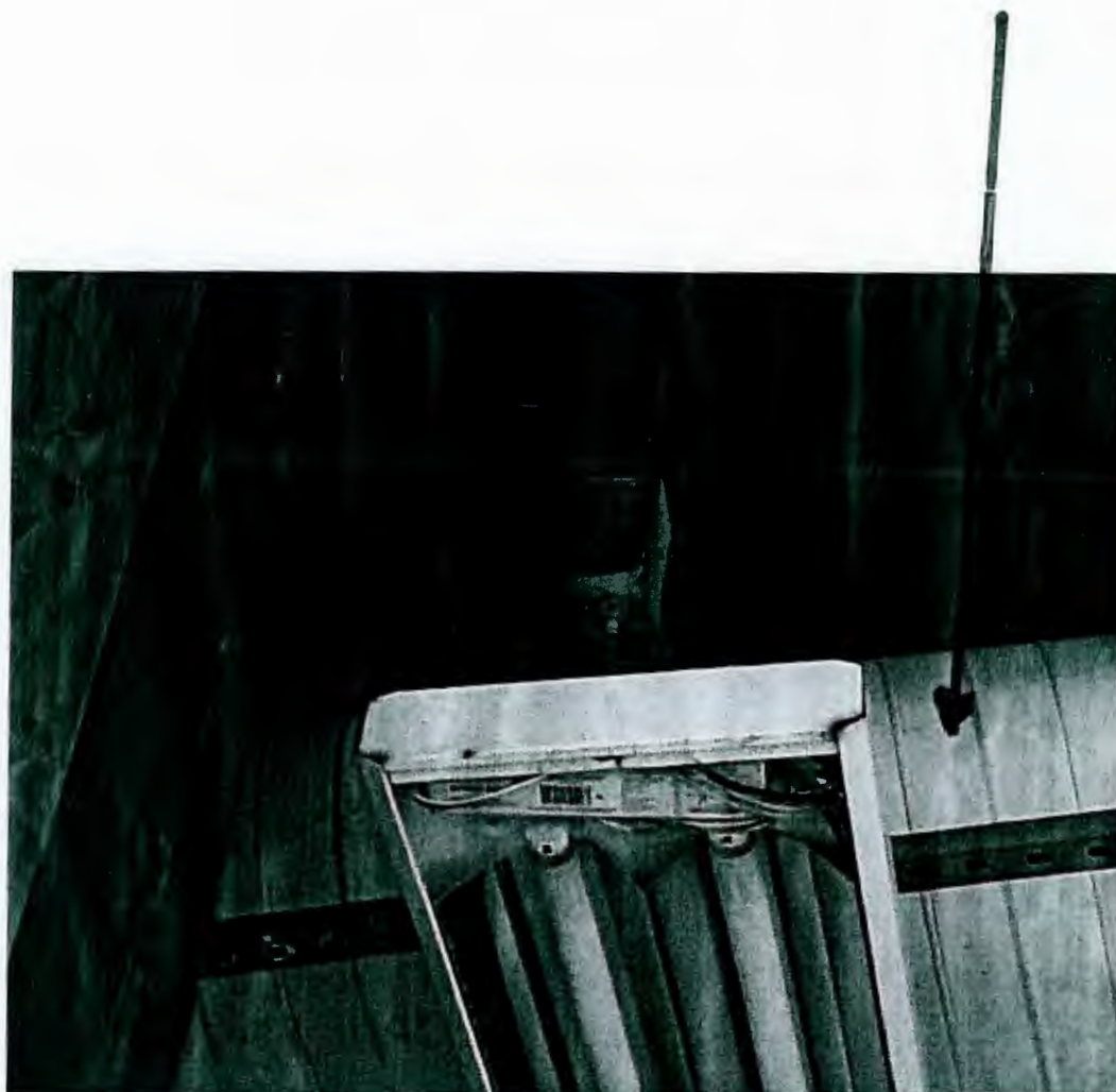
RECUPERAÇÃO DUTOS DE AR CONDICIONADO. DUTOS ENFERRUJADOS PELA INFILTRAÇÃO DE AGUA CAUSADO PELA PARALIZAÇÃO PROLONGADA DA OBRA
