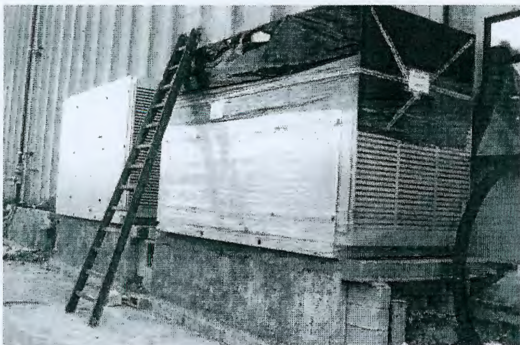
Equipamentos de Ventilação Forçada
