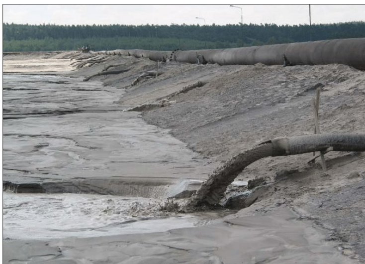
Figura 6 – Deposição de rejeitos de mineração na barragem 14 .
