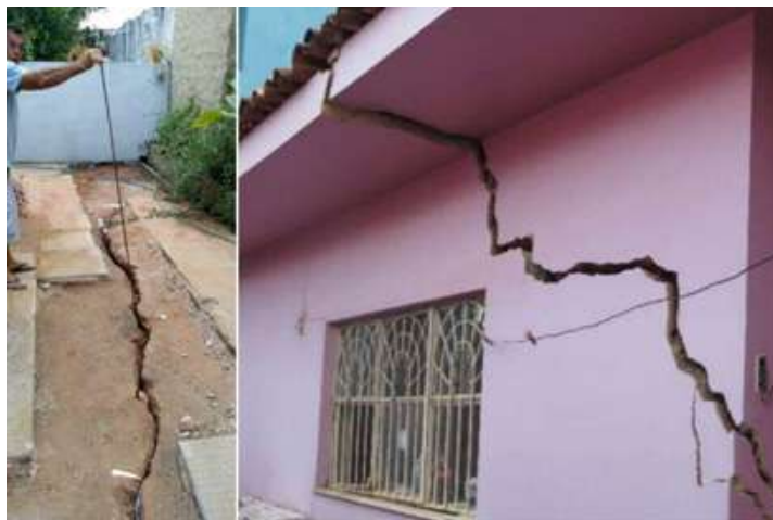
FIGURA 3 - IMAGEM DE RESIDÊNCIA DA REGIÃO, AFETADA PELA INSABILIDADE DAS CRATERAS
