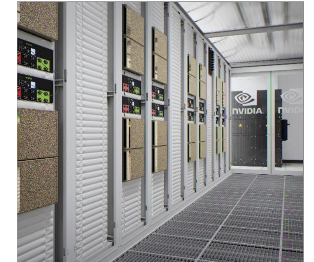
AI in the Data Center
