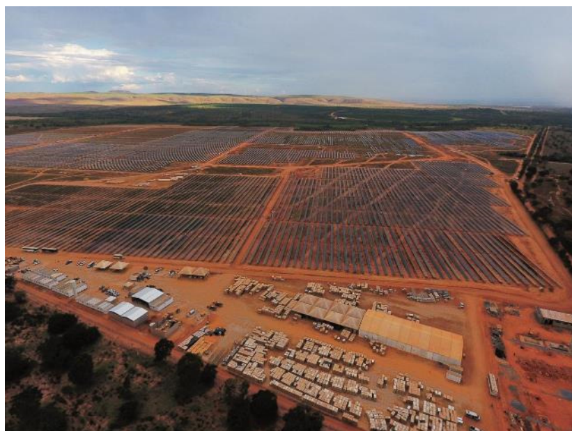
UFV de 185 MWp em Pirapora (MG).
