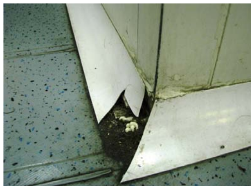
Rodapés danificados – São Bernardo do Campo/SP
