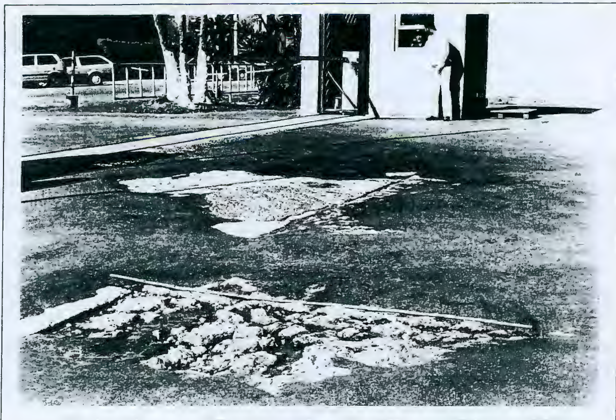
Fig. 1: decomposição da camada asfáltica (área carroçável) do térreo bloco III lado Mergenthaler
